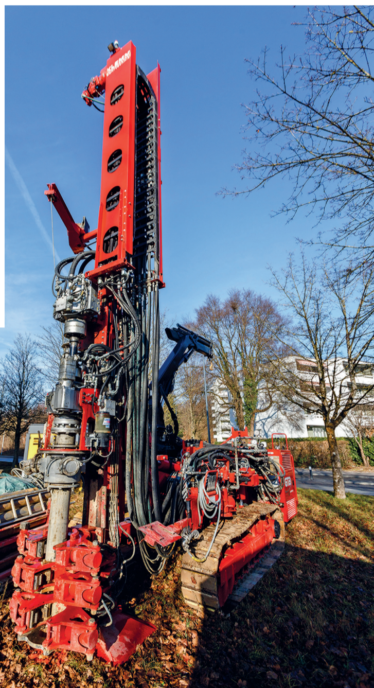
► Nicht an allen Standorten ist eine Bohrung für eine Erdsonden-Wärmepumpe möglich.
